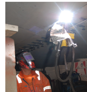
Sveiseleder Morten Solberg overvåker sveisingen, som skjer på over- og underside samtidig.
